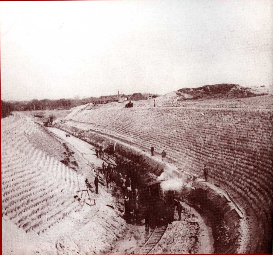
Verdiepen van het Zwarteveldkanaal in 1901, met arbeiders, smalspoortje en paard en wagen (foto: archief Historische Werkgroep AWD) (NB. Zwarteveldkanaal is het enige kanaal waarvan de oevers later niet zijn afgezand, het is nog steeds smal en diep, wel veel meer begroeid dan toen!)
